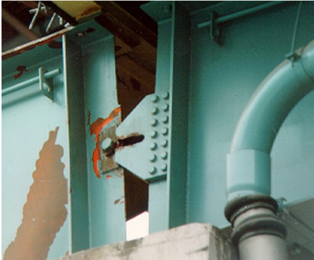
Photo 5 耐震連結装置の被害例とその効果
