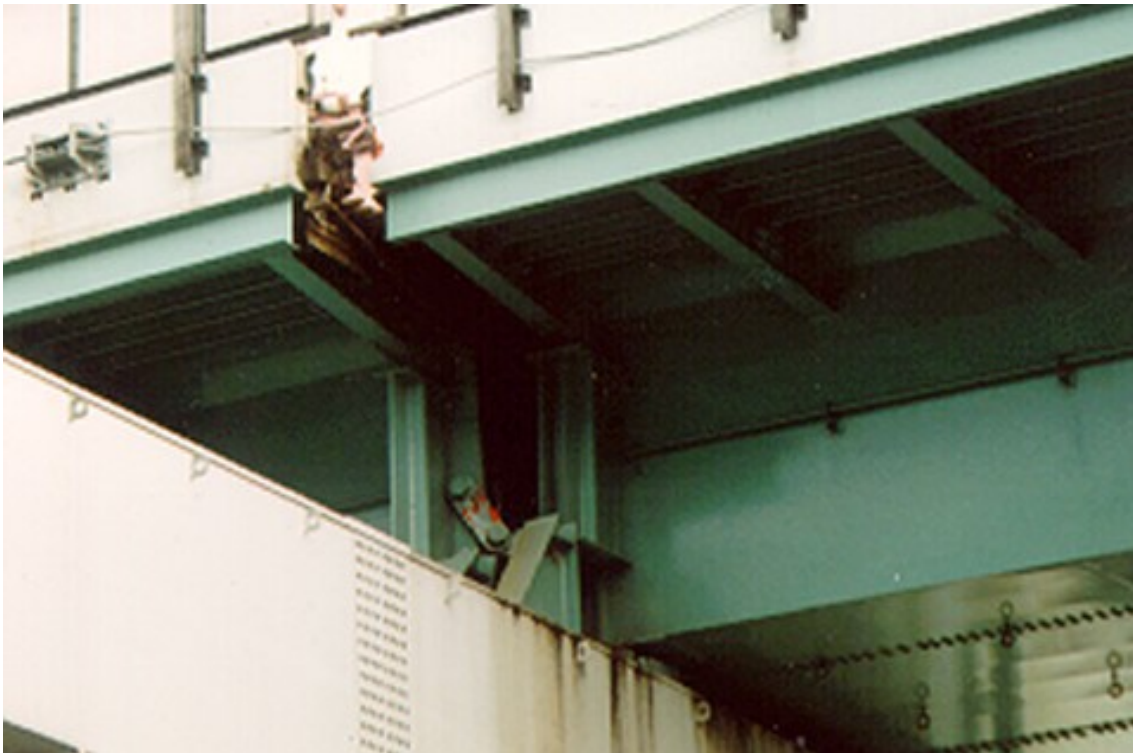
Photo 3 耐震連結装置の被害例と効果
