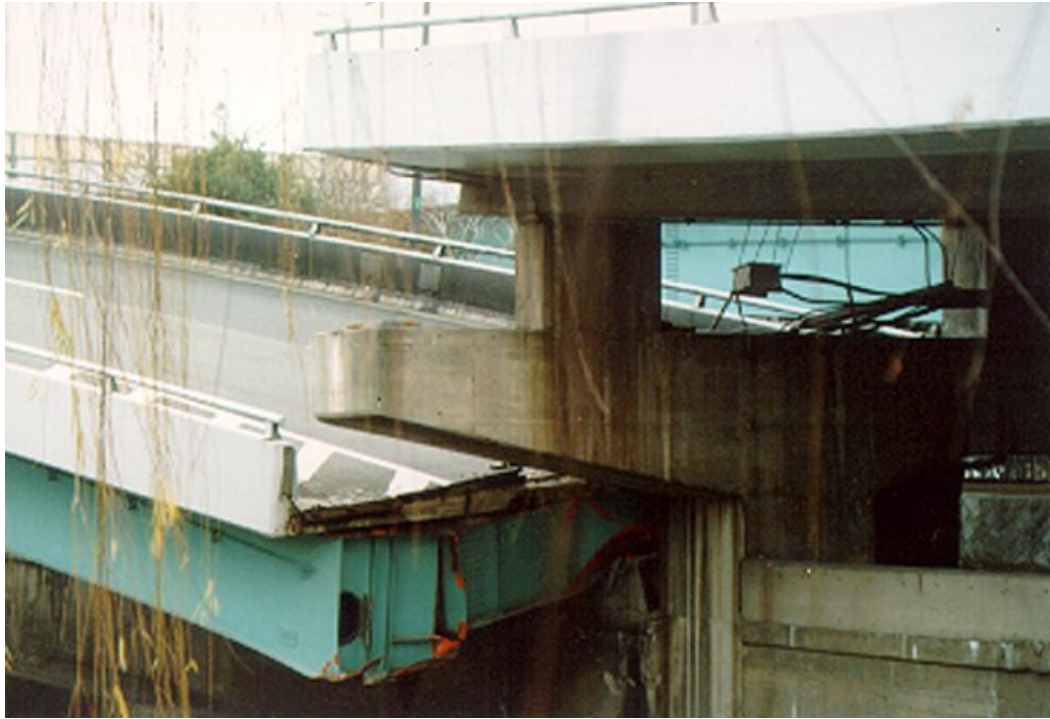
Photo 7 耐震連結装置の被害例（落橋；異種桁、曲線橋）
