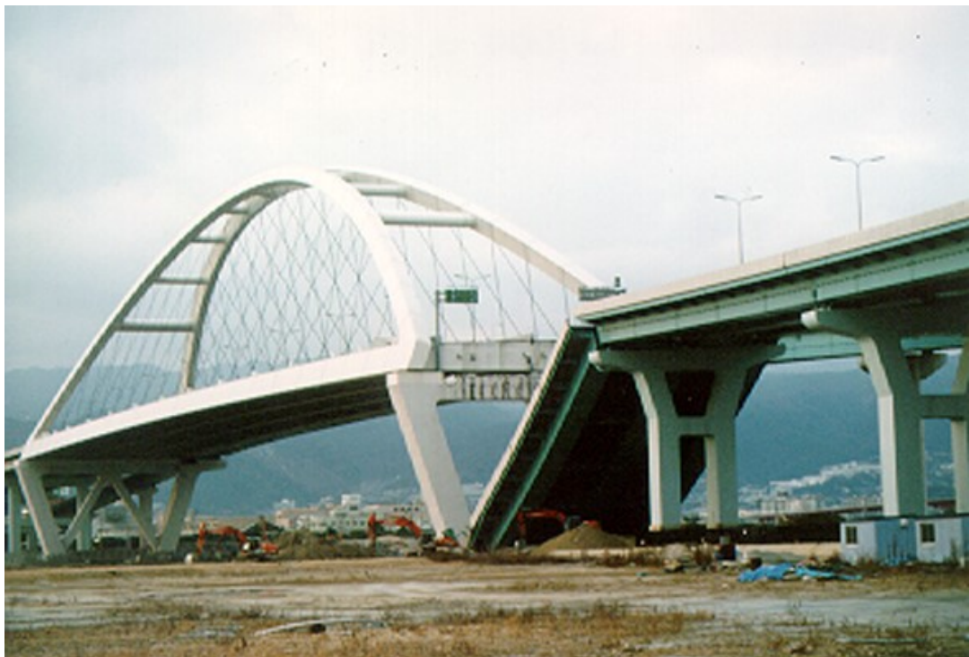
Photo 8 耐震連結装置の被害例（落橋；西宮港大橋、 橋脚規模と形式の異なる橋桁）
