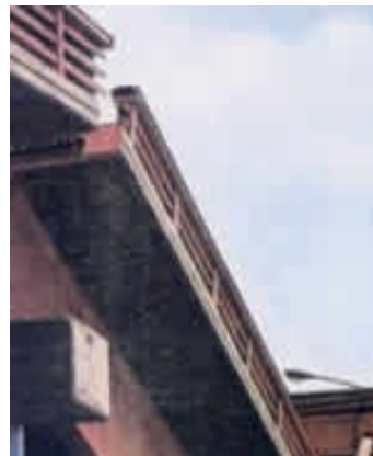
(B) 昭和大橋の被害
