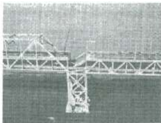
図 2.9 ロマプリータ地震での被害 2.2)
