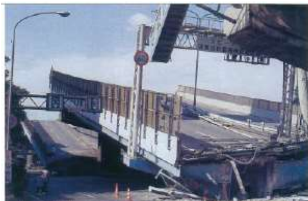
図 2.10 兵庫県南部地震による被害① 2.2)
