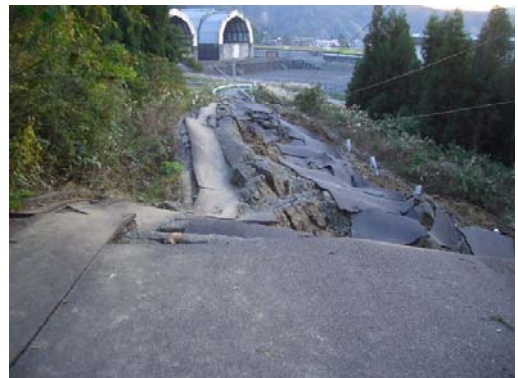
写真-7 新潟県中越地震による被災状況
