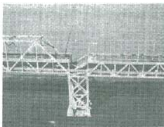
図-2.9 ロマプリータ地震での被害 2.2)
