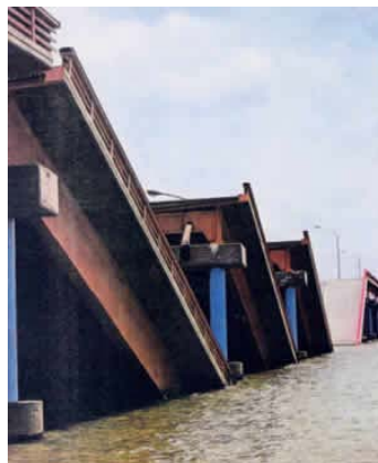
(B) 昭和大橋の被害
