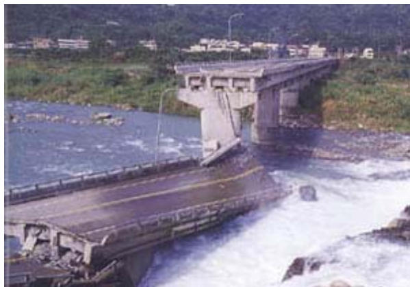
図-2.12 集集地震による被害① 2.2)
