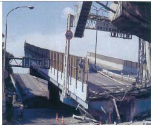
図-2.10 兵庫県南部地震による被害① 2.2)
