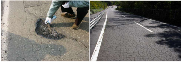
写真—1 ひび割れ大
