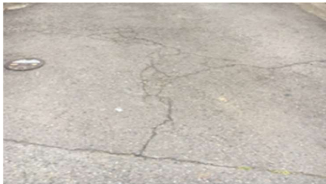
写真—2 ひび割れ中
