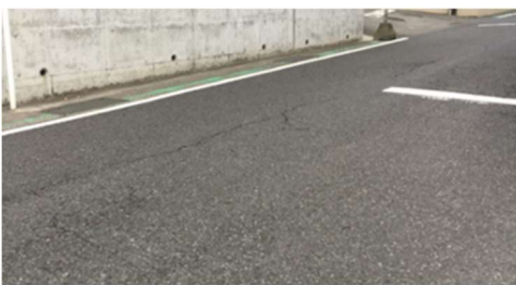
写真—3 ひび割れ小
