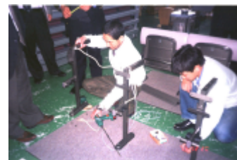
図4 固定機の改造と試作 (電源・情報コンセントの工夫)
