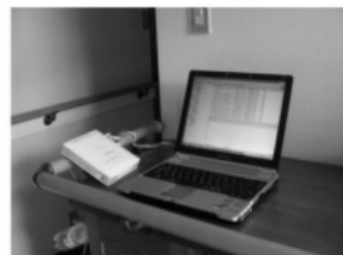
PLCからパソコンへ接続(1階)
