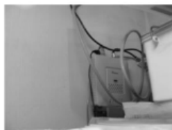
屋内ルーター(2階)
