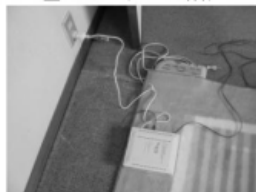
ルーターからPLCに接続(2階)
