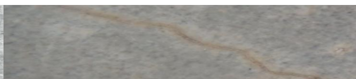
ひび割れ閉塞
